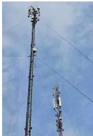
Hình 23.6. Các trạm BTS
